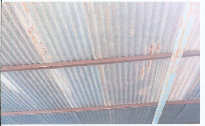
Foto 4: Cubierta dañada de la parte interna.
